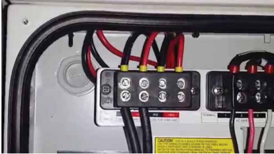
الشكل ٥٤: يوضح الجزء الخلفي للمبدل (Inverter)
